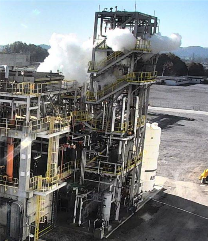
Εικόνα 1. Η πλατφόρμα όπου συνέβη η διαρροή. Δεκαπέντε δευτερόλεπτα αργότερα, η κατασκευή κατακλύθηκε από το νέφος (πηγή CSB report No. 2021-01-I-TN)
