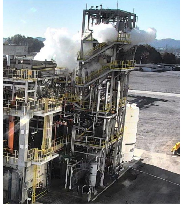
תמונה 1: משטח העבודה בו התרחשה הדליפה. 15 שניות מאוחר יותר, המבנה התכסה בעשן. (ר' דו"ח CSB מס' 2021-01-I-TN).
