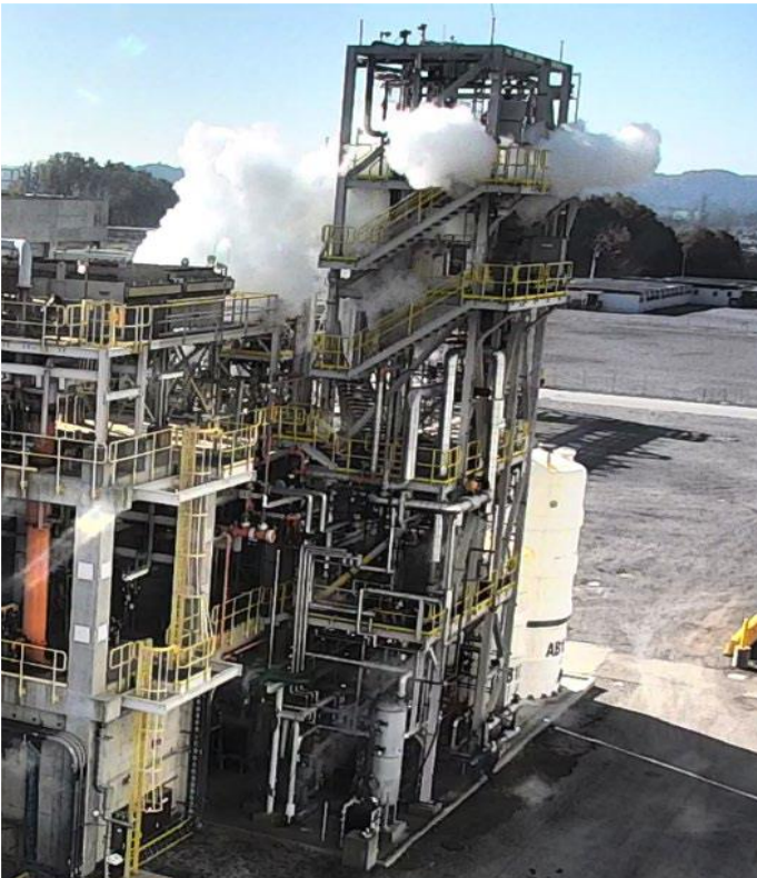
รูปที่ 1 แพลตฟอรมที่มีการรั่วไหลเกิดขึ้น 15 วินาทีต่อมาโครงสร้างนี้ถูกปกคลุมไปด้วยกลุ่มไอของสารเคมี (อ้างอิง CSB report No. 2021-01-I-TN)
