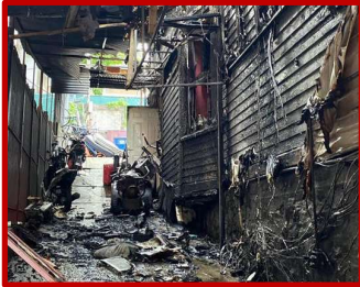
圖 1：鋰離子電池火災所造成的建築物損壞
