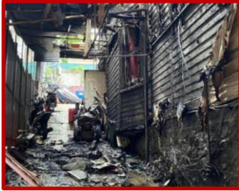
Figuur 1: Schade aan gebouwen veroorzaakt door een brand in een lithium-ion batterij.
