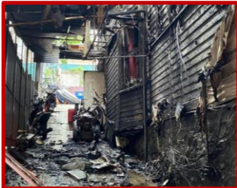
شکل ۱: خسارت به ساختمان به علت آتش سوزی ناشی از باتری لیتیوم-یون
