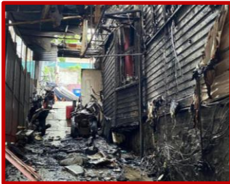
Εικόνα 1: Ζημιές σε κτίρια που προκλήθηκαν από φωτιά μπαταριών ιόντων λιθίου
