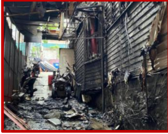
Rajah 1: Kerosakan pada bangunan yang disebabkan oleh kebakaran bateri litium-ion.
