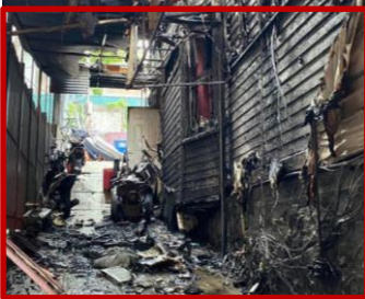
Poza 1: Deteriorarea clădirilor cauzată de un incendiu al bateriei litu-ion.
