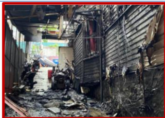
Рис.1: Повреждения зданий, вызванные пожарами от литий-ионных батарей.
