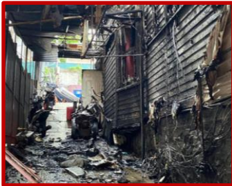
Figura 1: Daños en edificio, causados por incendio de baterías de litio.
