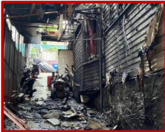
Hình 1: Thiệt hại của các tòa nhà do cháy pin lithium-ion
