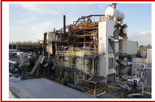
圖 1. 內部爆炸後的樹脂廠建築 (資料來源：CSB 報告編號 2021-04-I-OH)
