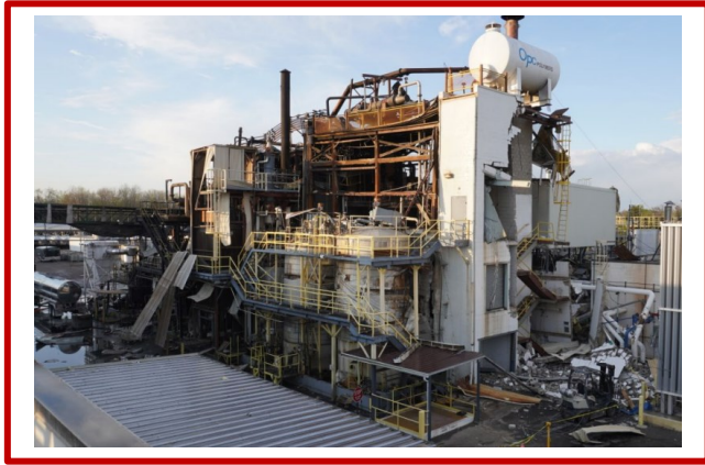
図1. 内部の爆発後の樹脂製造建屋
