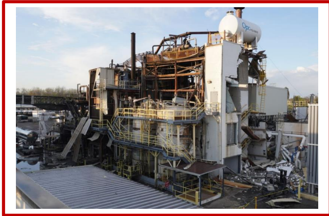
Figura 1. Edifício da resina após a explosão interna (Fonte: Relatório do CSB No. 2021-04-I-OH)
