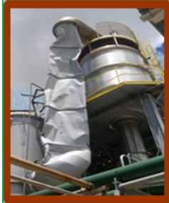
Фигура 1: Въздуховод към сушилня, разрушен поради възникване на вакуум
