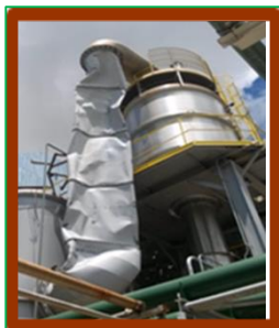
Figur 1: Indtag til en tørrer kollapsede under vakuum
