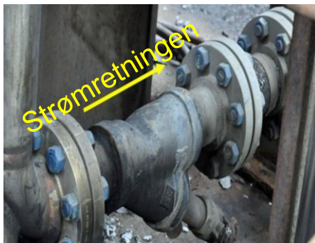
Figur 1. Støbejerns Y-filter forkert installeret i et rustfrit jernrørssystem.
