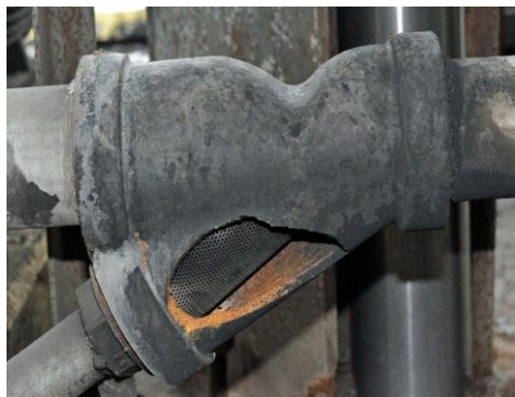
Figura 2. O gaură mare în filtru. Presiunea excesivă a provocat o fisura,
