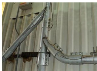
Conduits avec câbles de mise à la terre et à la masse
