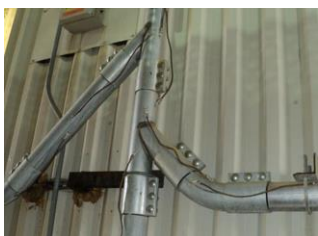
Hệ thống ống dẫn với cáp nối đất
