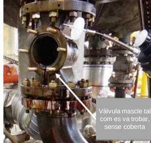
Figura 3. Vàlvula després de l'incident
