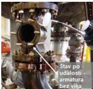
Obrázek 3: Armatura po havárii
