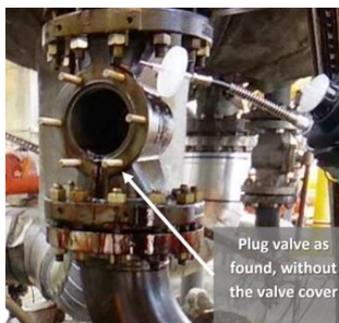
Figuur 3. Klep na het incident
