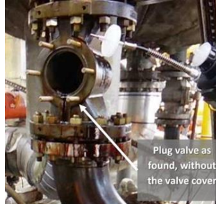
Kuva 3. Venttiili onnettomuuden jälkeen
