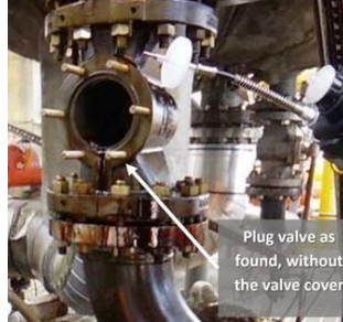
Gambar 3. Valve setelah insiden
