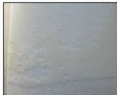
Figura N°02. Potencial de incrustación
