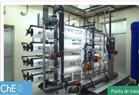
Planta de tratamiento de aguas de Key Colony Beach (FL, USA) Capacidad: 100000 gpd, 45% rec.
